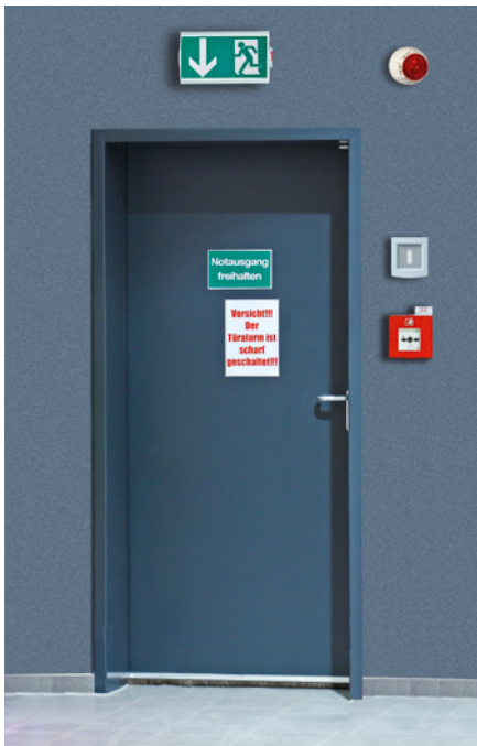
Türmodul comlock 410 mit cryptlock-Leser und Intern-Signalgeber an Fluchttür
